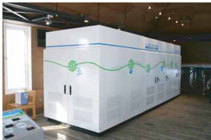
燃料電池システム全景
